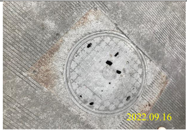
项目雨水井盖
