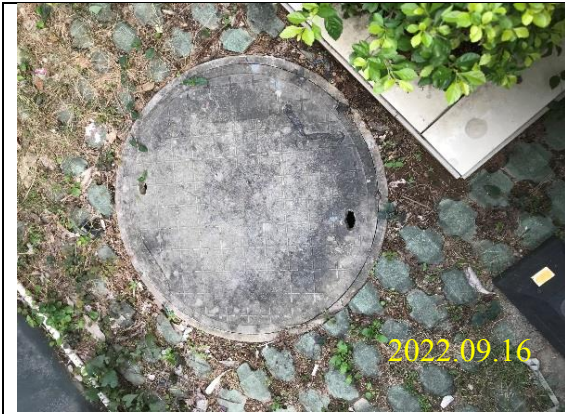
项目污水井盖
